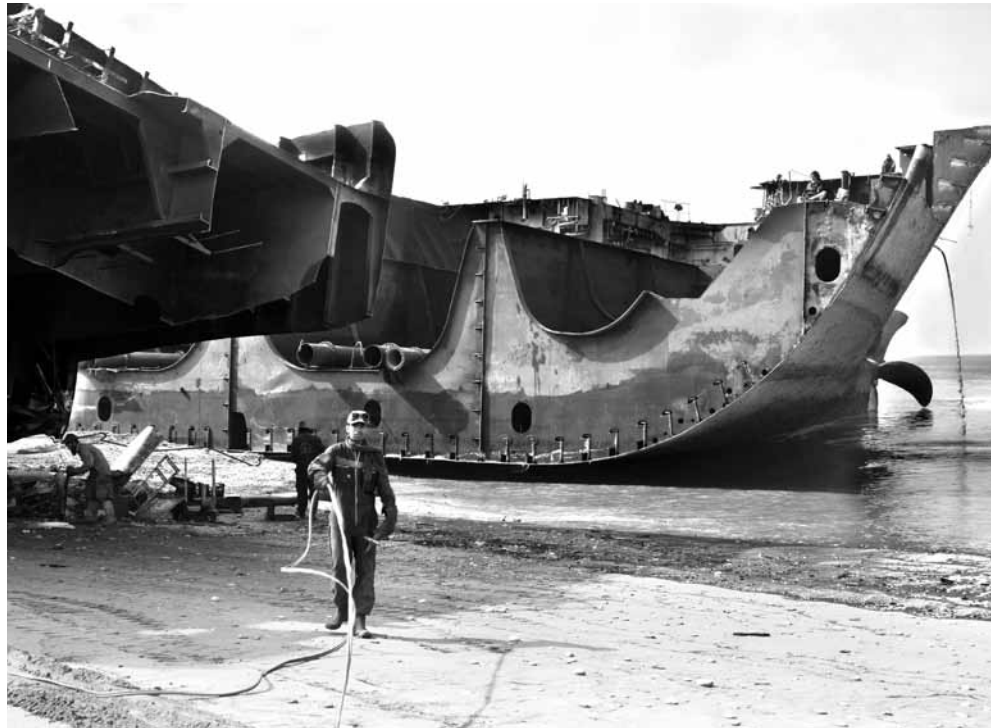
Sur la plage de Gadani, les ouvriers de la démolition navale travaillent dans des conditions aussi dangereuses que précaires. Photo: Yvonne Zimmermann
